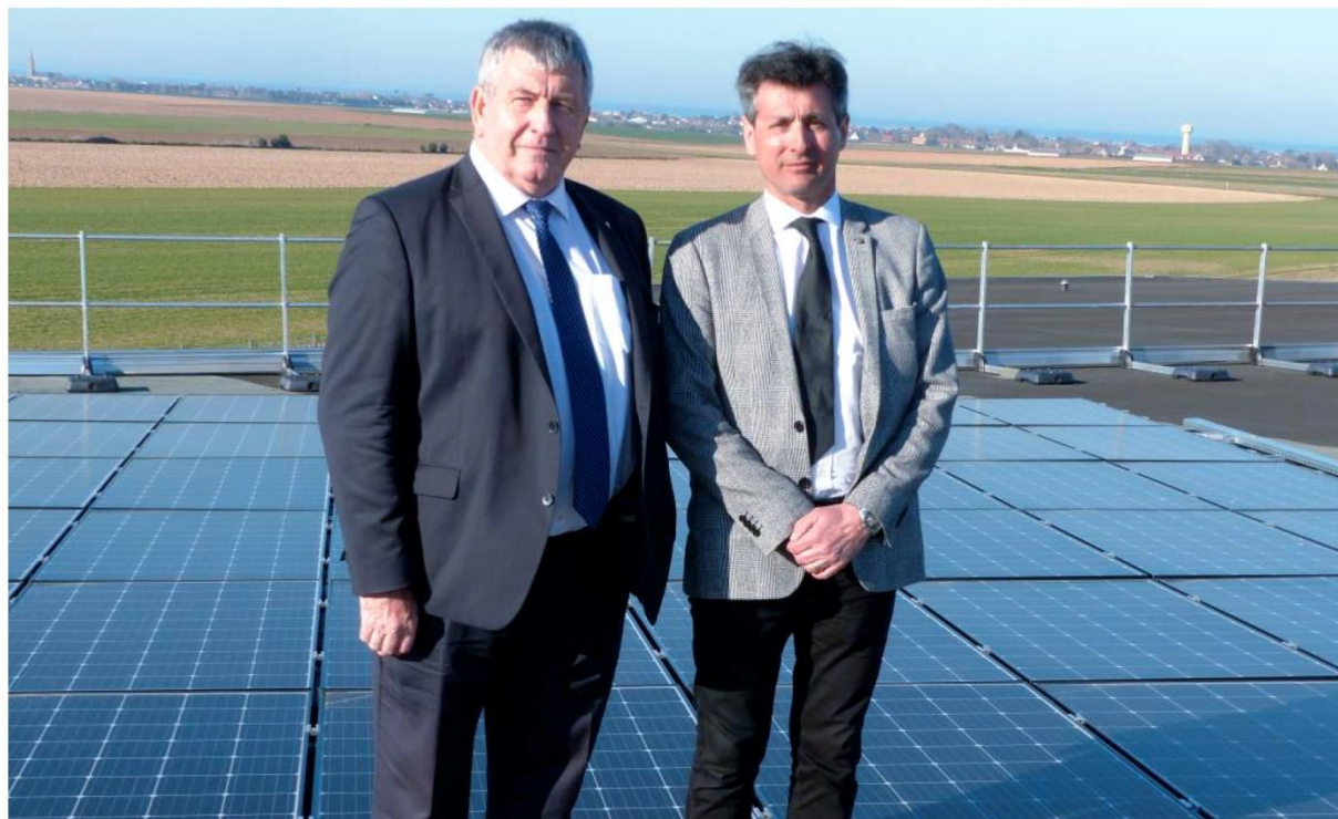
Jacques Lelandais, président du Sdec (à gauche) et Franck Jouy, président de Cœur de Nacre se sont rendus sur le toit du centre nautique Aquanacre où sont implantés les panneaux photovoltaïques.
